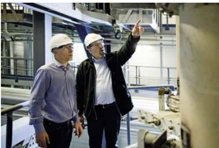
Et virvar af rør og maskiner udgør til sammen Avedøreværkets blok 2, som i de sidste ti år har gennemgået en markant ombygning til 100 procent biomassefyring.
