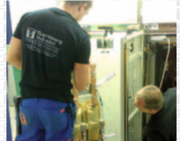
Kontrol af højspændingsbryder
